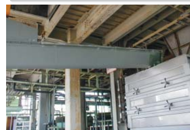
破碎した汚泥を スクリュコンベアで 乾燥機へ移送
